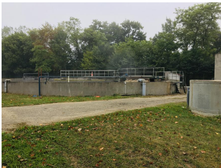
Station d'épuration Penne- Saint Sylvestre
